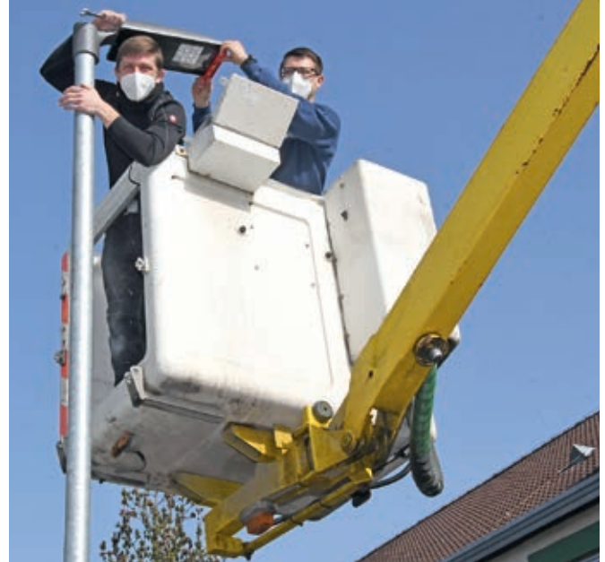
Langenlois investiert mit moderner Beleuchtungstechnik in den Klimaschutz. Die Firma AES betreut jetzt die öffentliche Beleuchtung (im Korb: Stadtrat David Falböck und Sascha Lafer von AES).
